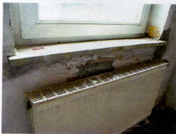
Beispielhaft: Putz- Feuchtigkeitsschäden
