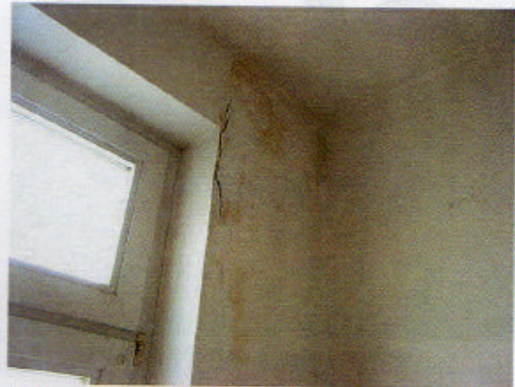
Beispielhaft: Putz- Feuchtigkeitsschäden
