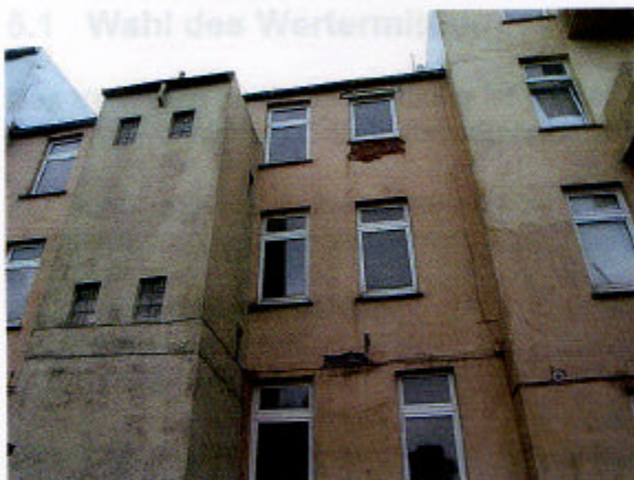
Schäden an der Hoffassade
