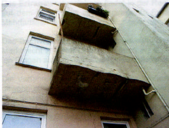
Schäden an den Balkonen
